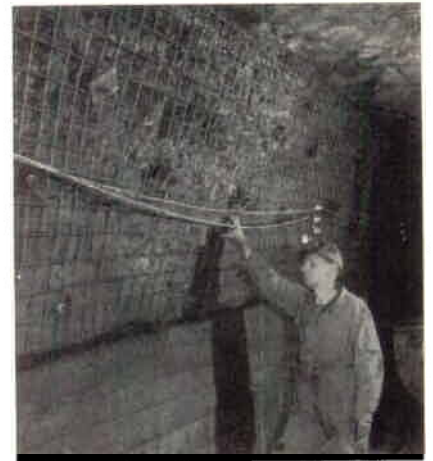
Förman Harry Lindberg kontrollerar armeringsnätet före besprutningen med betong. Detta ingår som ett led i förstärkningsarbetena i de gamla gruvorterna, som skall utnyttjas för vagns-omloppet under jord vid det nya centralschaktet i Skromberga gruva.
