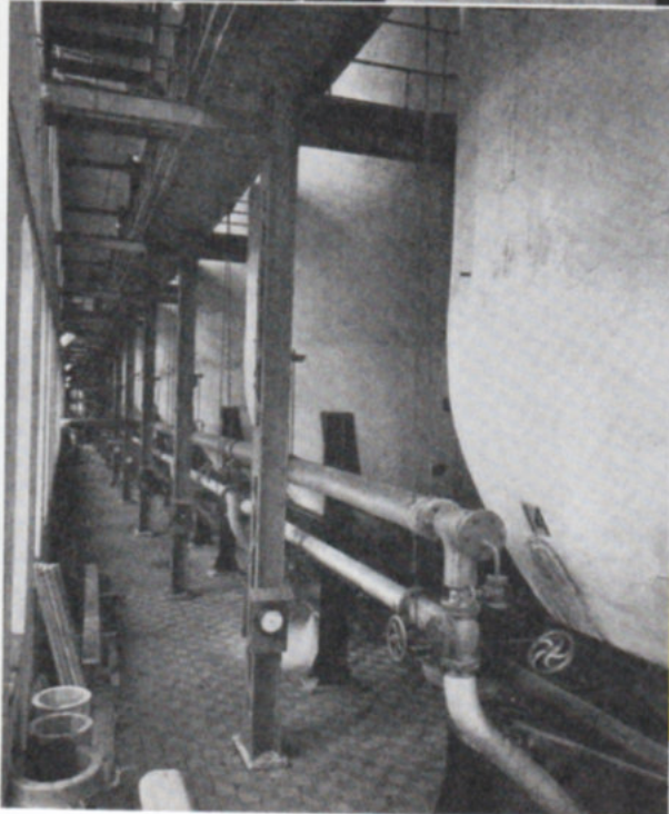
Att infodra cellulosaindustrins kokare med Höganäs kokartegel är en av Höganäsarbetens specialiteter. De avbildade kokarna återfinns vid Svartviks AB, där golvet i kokeriet — ett av världens största sulfittokerier — dessutom belagts med Höganäs klinker.
