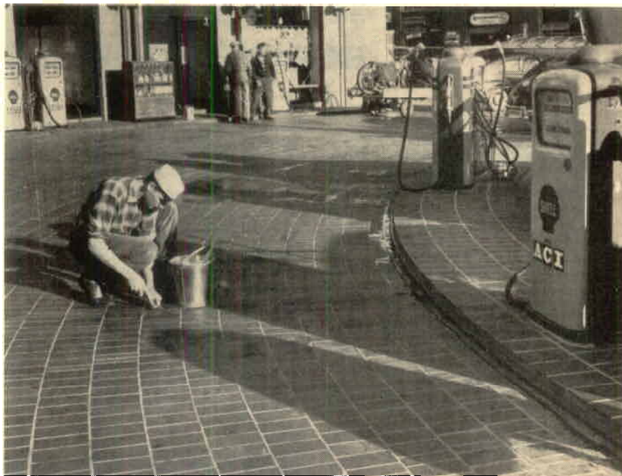
Åtskilliga Skromberga golvplattor placerades genom AB Höganäsarbetens försorg på planen vid Shells huvudstation i Stockholm. Det är plattsättare Emil Jönsson vi ser på bilden. Han är sysselsatt med efterfogning.
