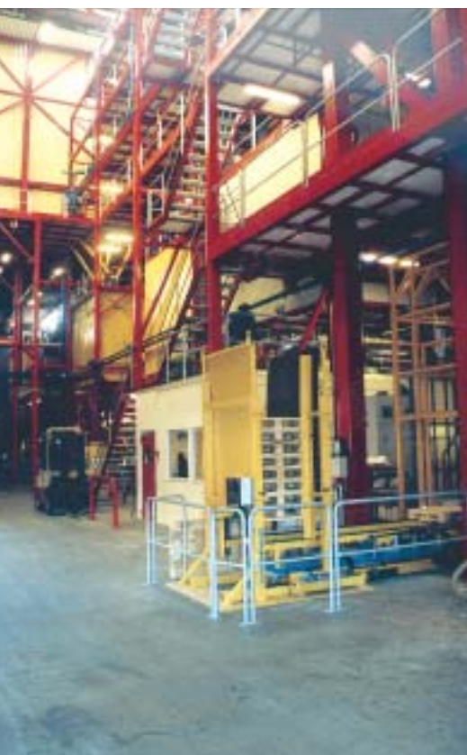
Finpulververket har plats för ytterligare produktionslinjer och utrustning. Processen styrs och övervakas från kontrollrummet till höger i bilden.
