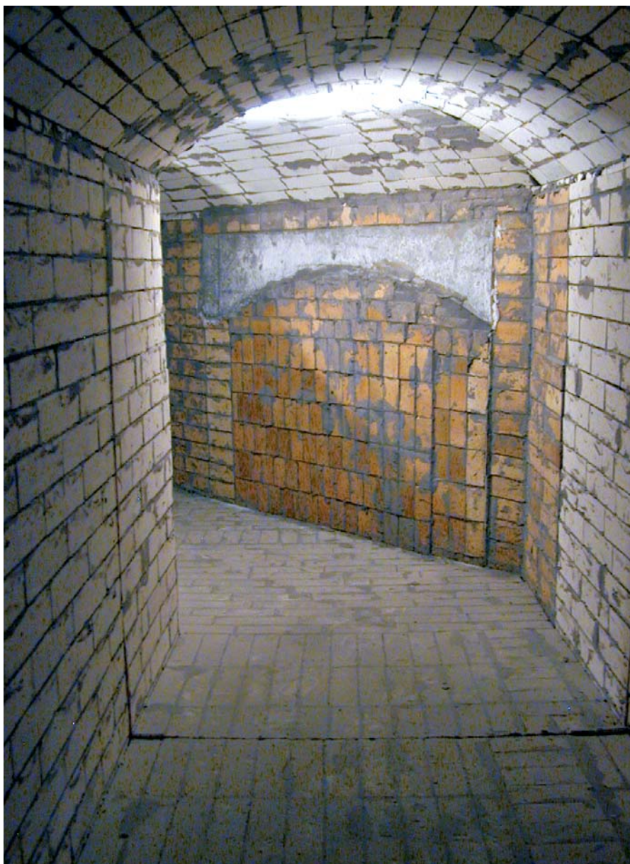
Omfattande ombyggnadsarbeten har gjorts i Pulververket, där bl a betonggolvet grävts upp för att bygga en lång och djup rökgaskulvert.
