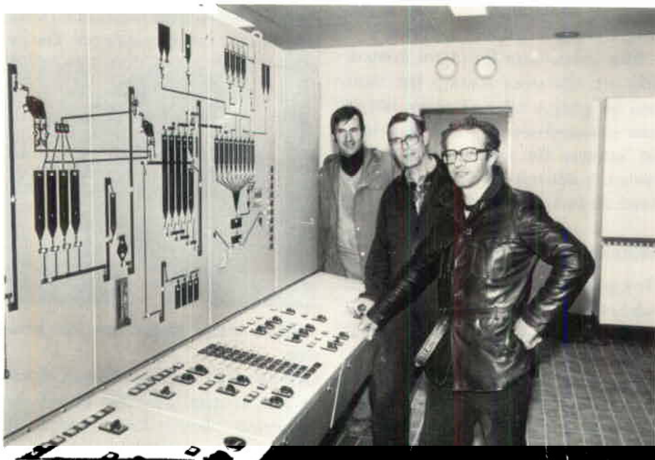
Hans Zetterström, driftsingenjör, Heinz Drewitz och Richard Nilsson från NVSK vid manöverbordet i KM 79:s kontrollrum.
