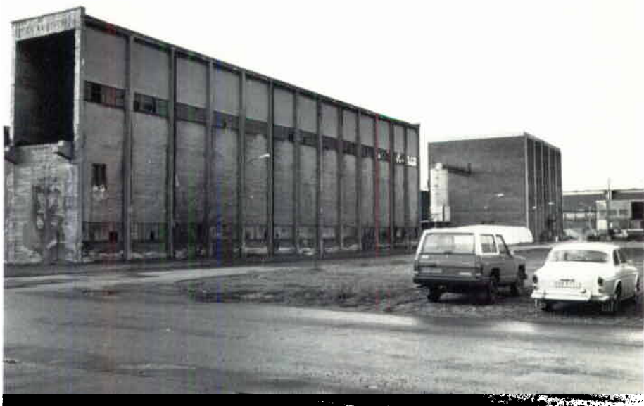
– Man kan väl åtminstone spika för de trasiga fönsterrutorna, tycker en anställd som hört av sig till redaktionen och klagat på gamla byggnader som förfaller inom industriområdet.
