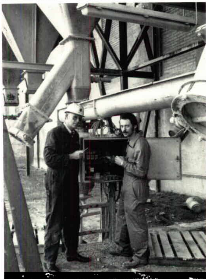
Torsten Johnsson, tv, diskuterar ett förbättringsförslag med elektriker Arne Johansson. Det gäller en förbättring av sändaren till filterutrustning för massaberedningen vid Bjuvsverken.
