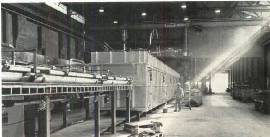
Bengt Persson, som i vanliga fall är kontrollrumsoperatör, hjälper till med torkeldningen av det senaste tillskottet i Pulververkets ugnspark, ugn 23.
