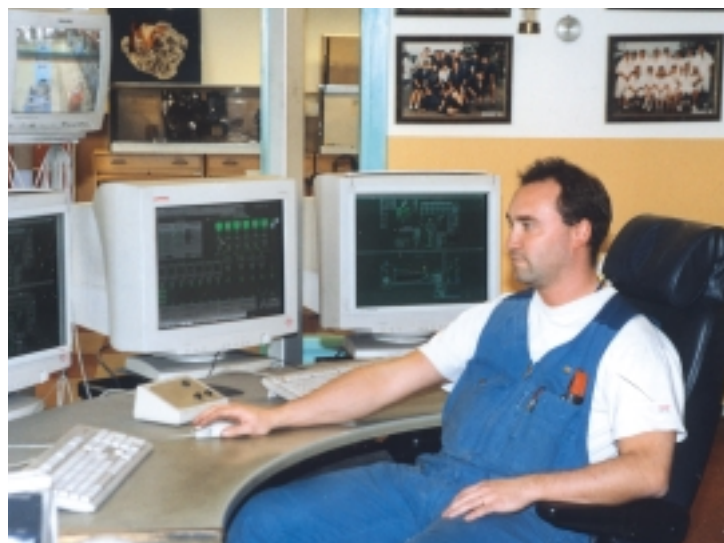
Från kontrollrummet i Distaloyverket övervakar Kenth Olsson alla processer i Distaloy – och Astaloyverket.
