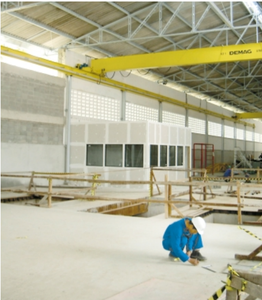
Fabriken inifrån med det välutrustade kontrollrummet till vänster.
